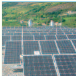
Photovoltaikanlage des Forschungszentrums EURAC in Bozen.
