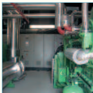
Gasmotor der Biogasanlage Strem. (Foto: EEE Güssing)
