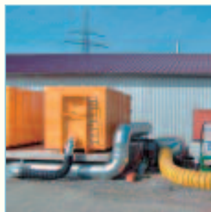
Die Abwärme der Biogasanlage Korbach-Lelbach wird zur Trocknung von Holzhackschnitzeln genutzt (gelbe Container). Die weißen Boxen (Bildmitte, hinter dem gelben Schlauch) dienen der latenten Wärmespeicherung, die in einem Pilotprojekt getestet wird.
