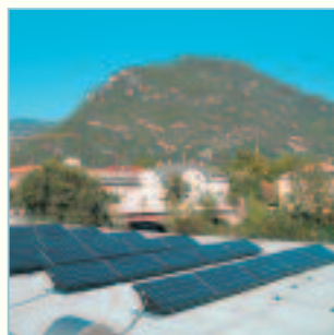
Photovoltaikanlage beim Fernheizwerk Schluderns.
