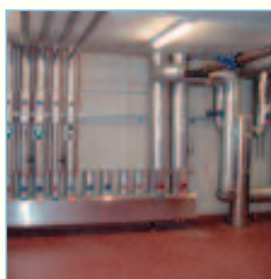
Im Betriebsgebäude der Kläranlage Ittertal. (Foto: Stadtbauamt Korbach)
