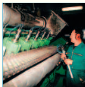
Gasmotor im Biomasse-Kraftwerk Güssing. Dieser Motor erzeugt aus dem Produktgas Strom.
