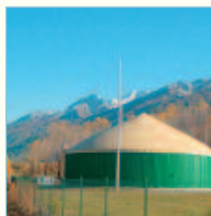
Die Biogasanlage Prad am Stilfser Joch mit einer Leistung von 250 MW wurde 2002 in Betrieb genommen.
