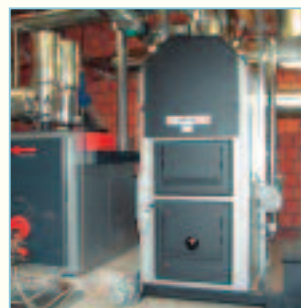
Heizkessel der Holzhackschnitzelfeuerungsanlage Bad Wildungen. (Foto: EWF GmbH)
