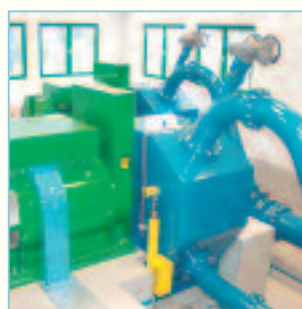
Im Inneren des Wasserkraftwerkes Gsies.
